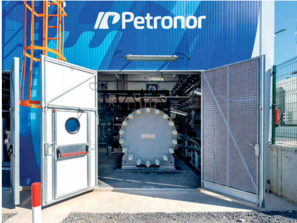
Imagen de un electrolizador de Petronor en el puerto de Bilbao.
